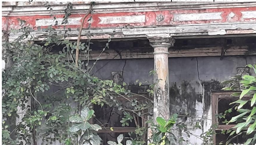
Figura 18: Fissuras e infiltrações nas paredes e pilares
