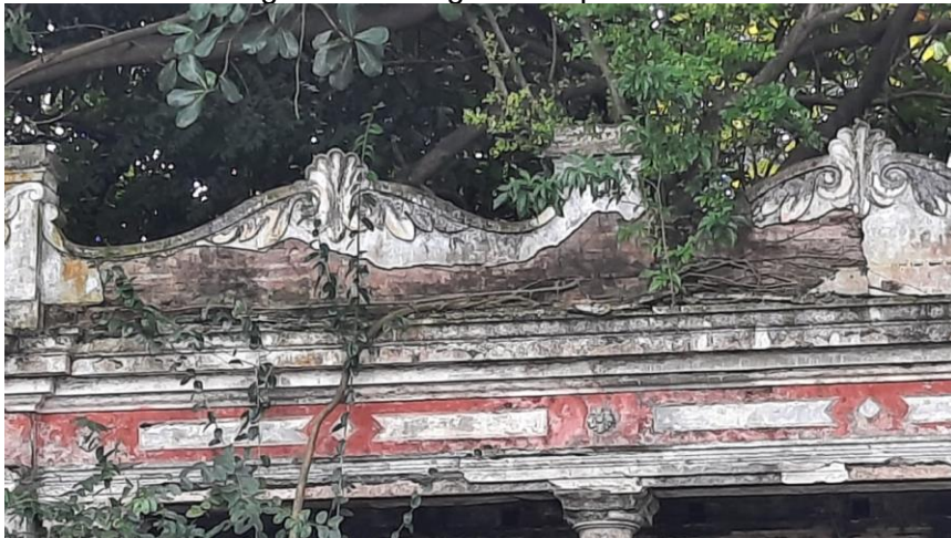
Figura 17: Desgaste da platibanda
