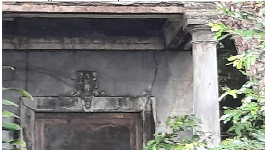
Figura 16: Parte superior da varanda sem forro
